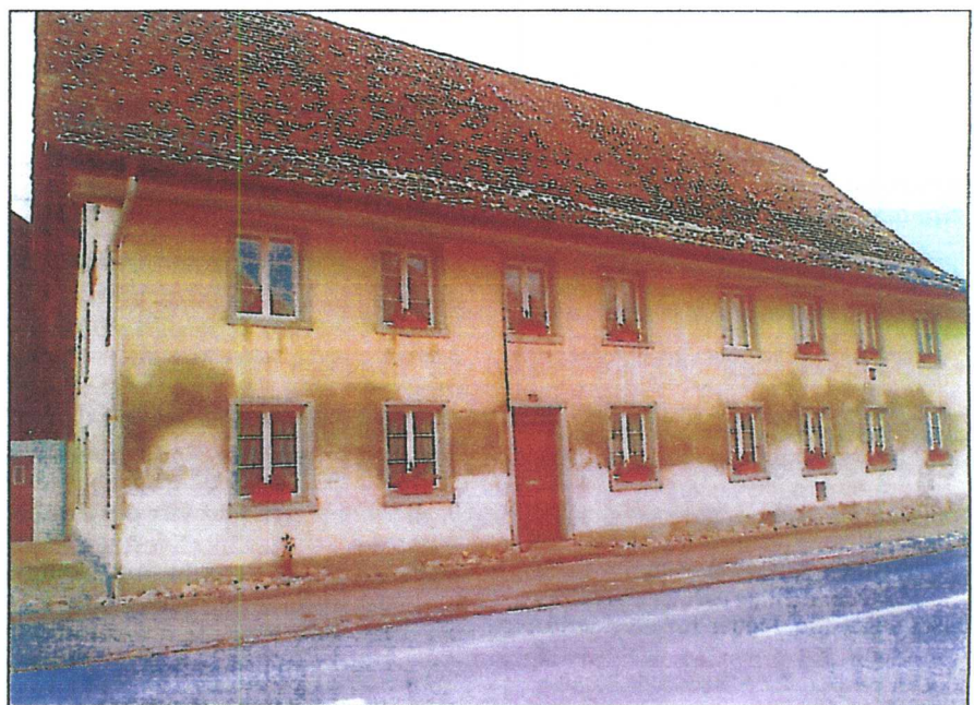
Typisches Beispiel eines falsch sanierten Fassadensockels.
